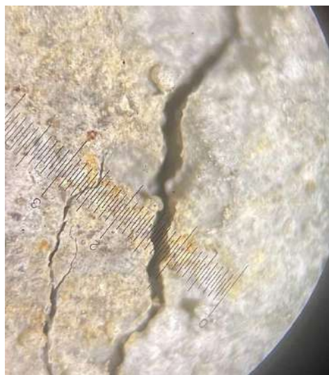
Рис. 8. Плита ПД2-9,5 (М). Утворення поверхневих тріщин по довжині прольоту між опорами (під час максимального завантаження)
