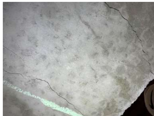
Рис. 6. Структурні тріщини в нижній розтягнутій зоні плити ПД2-9,5 (СК)
