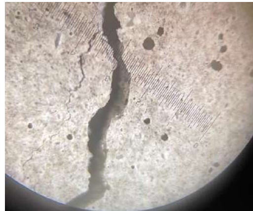
Рис. 5. Плита ПД2-9,5 (СК). Утворення нормальних тріщин по довжині прольоту між опорами (після розвантаження)
