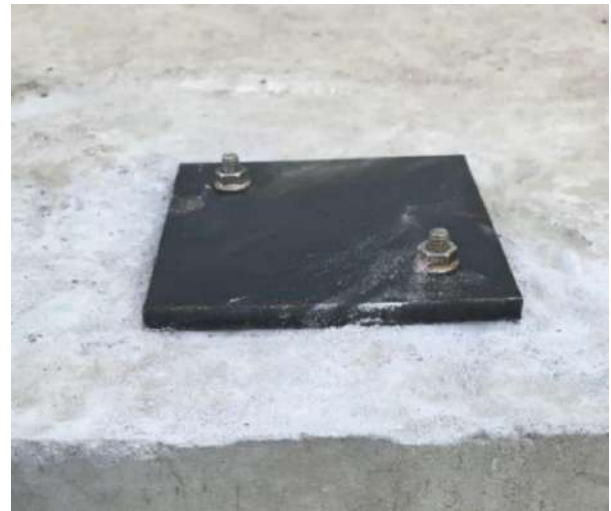
Рис. 6. Деформаційна марка на фундаментах силосів для зберігання зерна 10.1–10.12
