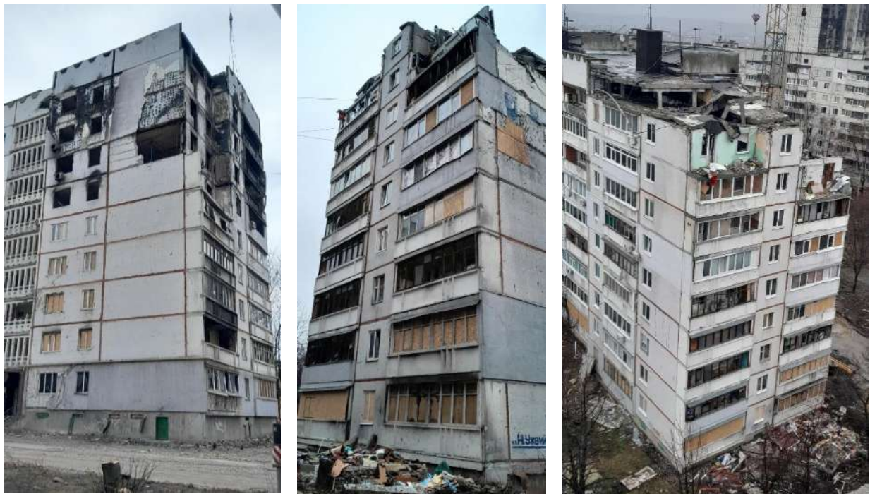
Рис. 3. Загальний вигляд будівлі після обстрілу
